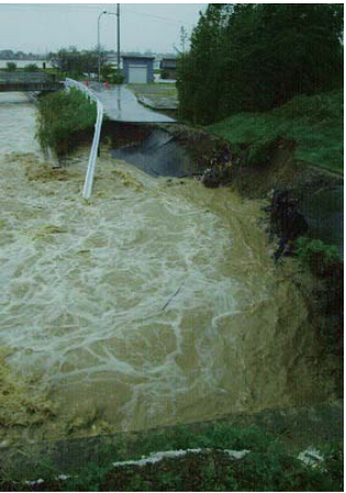
崩壊した県道（黒谷川堤防）
